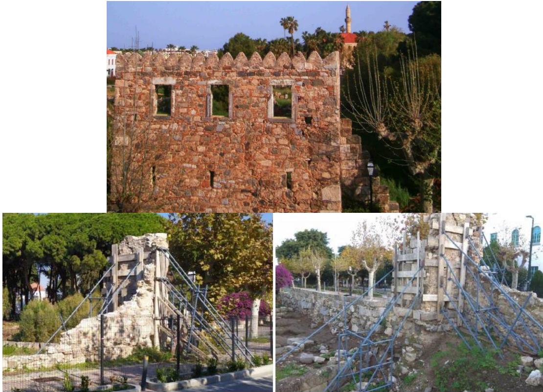
Εικ. 6: Τμήμα KM1179 οχυρώσεων (μικρή οχύρωση) επί της οδού Ιπποκράτους πριν (επάνω) και μετά τον σεισμό του 2017 (κάτω). Υποστυλωμένη η ΝΑ γωνία, η οποία θα πρέπει να αναταχθεί.
